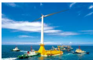
洋上風力発電施設の建設風景 出典：株式会社グローカル
